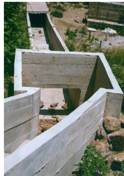
(c) caixa de passagem
