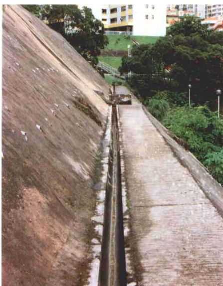
(a) Canaleta transversal
