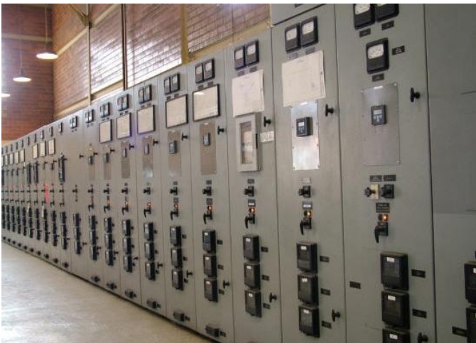
Fig. 10. Os estudantes efetuaram os ajustes dos relés digitais para substituir os relés eletromecânicos dos alimentadores da usina de vapor da WSU.
