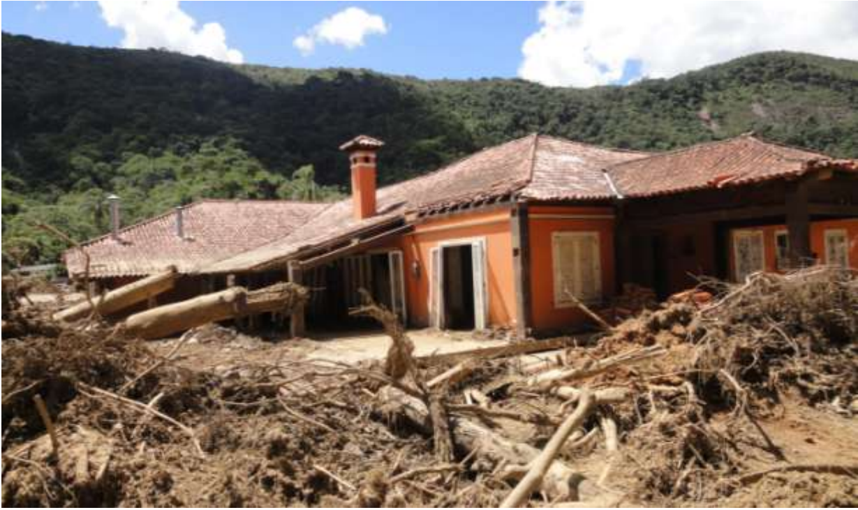
Figura 56: Vale do Cuiabá. Foto (25.01.2011) mostra casa destruída pela força das águas. Nesta casa, construída à margem do rio (parcialmente dentro de APP) e localizada a aproximadamente 200 metros a jusante da ponte representada na Figura 55 , morreram 9 pessoas.
