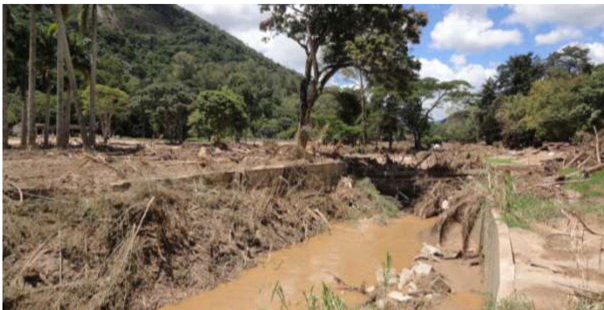
Figura 55: Vale do Cuiabá. Foto (25.01.2011) mostra ponte estreita, obstruída por detritos e canalização do rio a jusante da ponte. Destaca-se que nos casos de grandes enxurradas as canalizações, feitas para retificar o curso d'água e acelerar seu escoamento, acabam potencializando os efeitos das enchentes.
