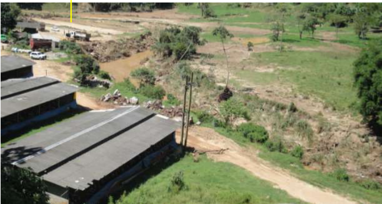
Figura 60: Vale do Cuiabá. Foto (25.01.2011). Galpões edificadas em APP, destruídos pela força das águas.
