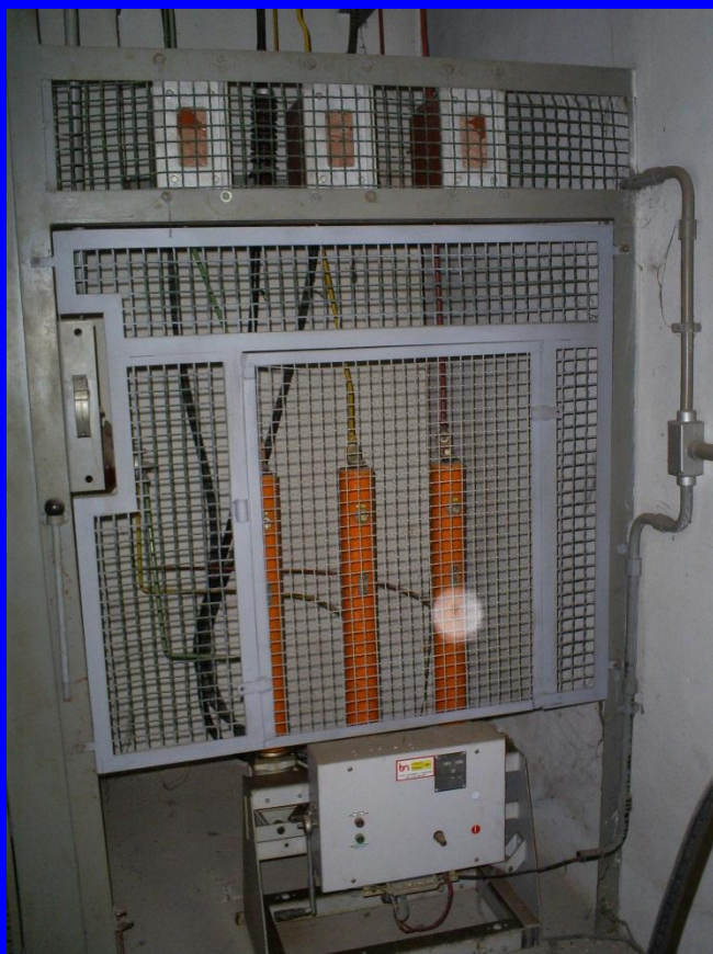
DISJUNTOR DA ALTA TENSÃO
