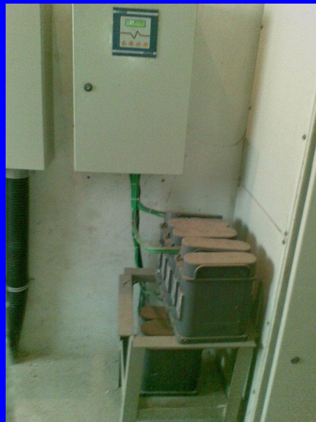
Banco de capacitores
